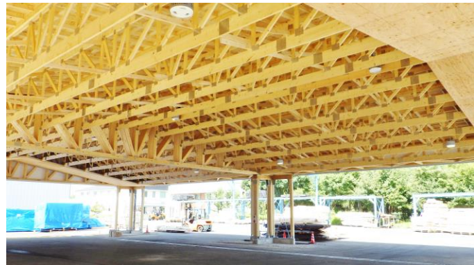
スマート倉庫内観
